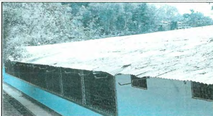
Foto 1: Se observa el deterioro de las láminas.
